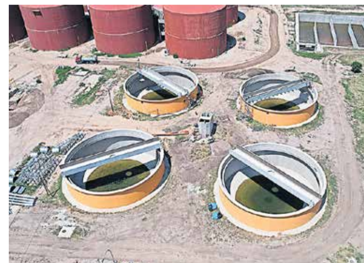
ESPEADORES DE BARRO. Otro de los componentes clave del proceso de tratamiento de efluentes.
