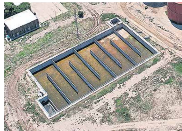
CÁMARA DE CLORACIÓN. Las salas de cloración son comunes a ambos módulos de la planta modificada.
